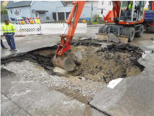
Straßenaufbruch nach Wasserrohrbruch Bergermühlstraße
